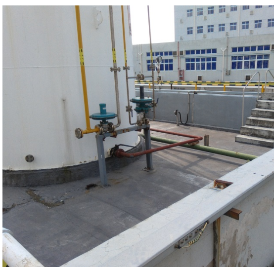
综合储罐区围堰
